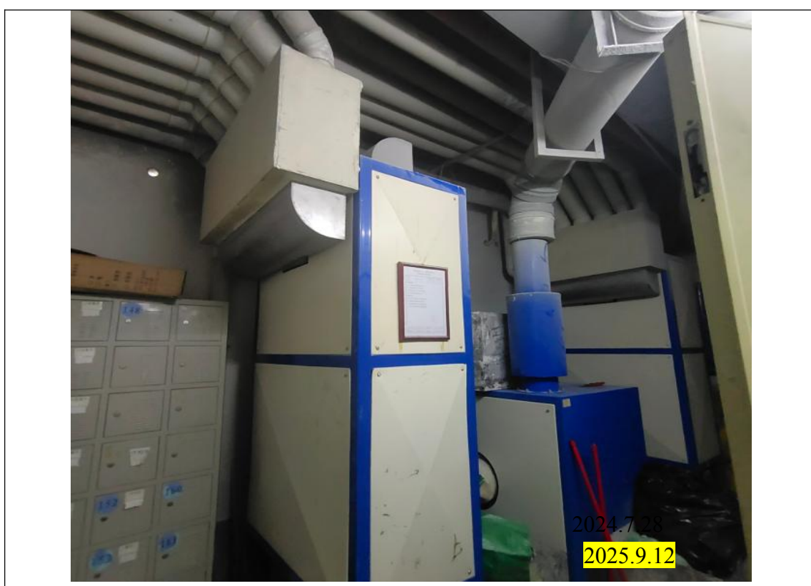
废气处理设施-除尘器
